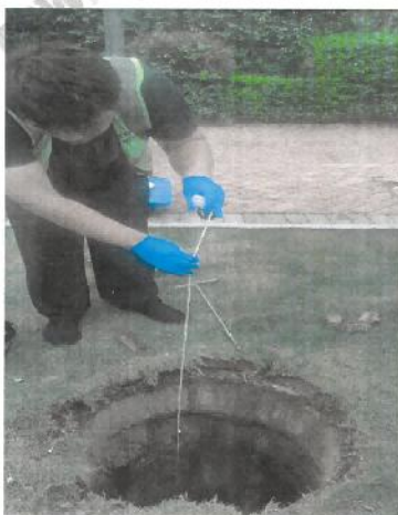
生活污水排放口
