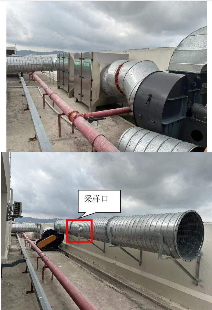
废气处理设施及处理后采样口
