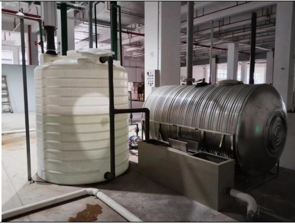
废水收集处理措施
