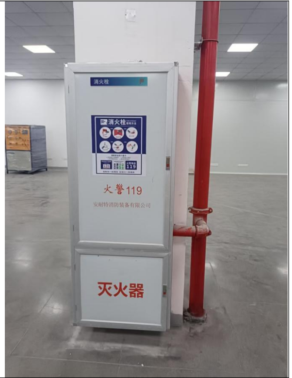
消火栓、灭火器箱
