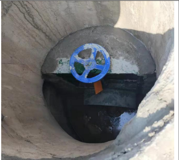
雨水排放口及与雨水总闸
